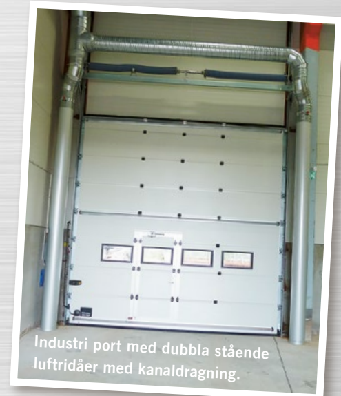
Entré med dubbla stående lufttridåer, där kanaldragning och fläkttagg ligger i undertaket.
